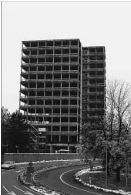
Auch Hervorragendes ist vor dem Altern nicht gefeit. Das Bürohochhaus der SRG muss vollständig saniert werden, damit weiterhin hervorragendes Radio produziert werden kann.
