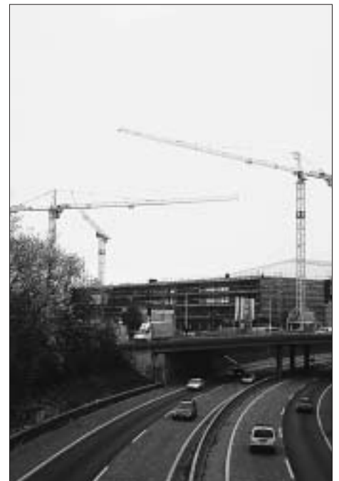
Auch wenn für den Ausbau des Eisstadions mehrere Kräne in den Himmel ragen, ist damit noch nicht gewährleistet, dass in Zukunft immer hervorragendes Eishockey gespielt wird.
