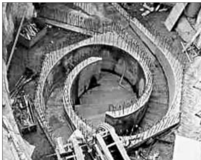
Wirbelfallschacht in der Länggasse im Bau (ähnlich wie der an der Surbekstrasse). (Fotos: Tiefbauamt, Bern)
