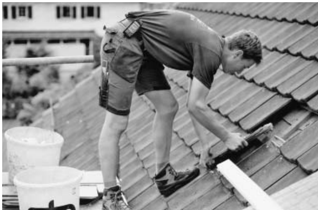
Der Beruf des Dachdeckers ist körperlich anstrengend, sagt Daniel Krall. Dies mag ein Grund sein, dass nur ganz wenige Frauen diesen Beruf erlernen und ausüben. Foto: vk
